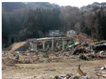
倒壊した駅舎と橋脚
