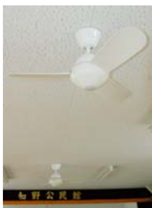
和野公民館に設置した天井扇
