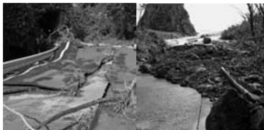
北山港線は土砂が流れ込み、アスファルトもめくれた
