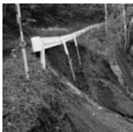
路肩が崩れた明戸北山線
