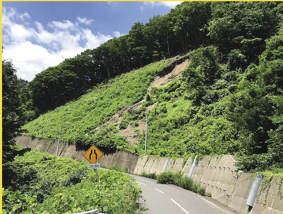
村道ハイベ線土砂災害現場
