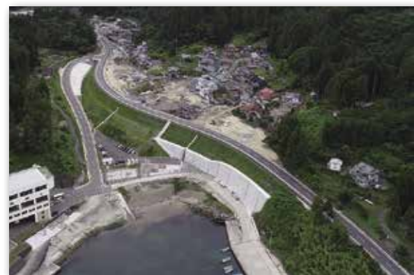
県道に隣接する水産関連用地の造成工事が進む（写真③）
