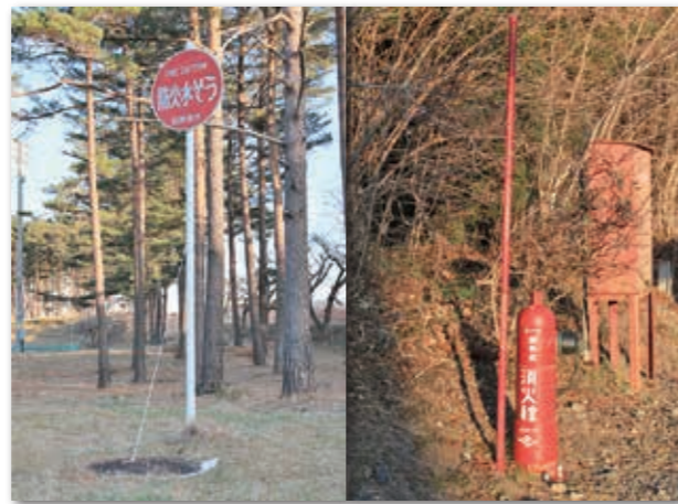
冬季の防火水槽⑤と消火栓⑥
